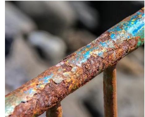
錆・経年による変化
