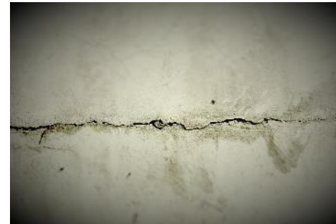
物理的な破損
